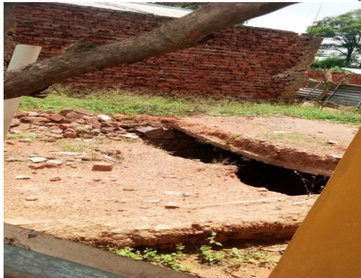
Fosse septique non utilisée et non protégée au Centre de Santé de Référence de MANGINA
